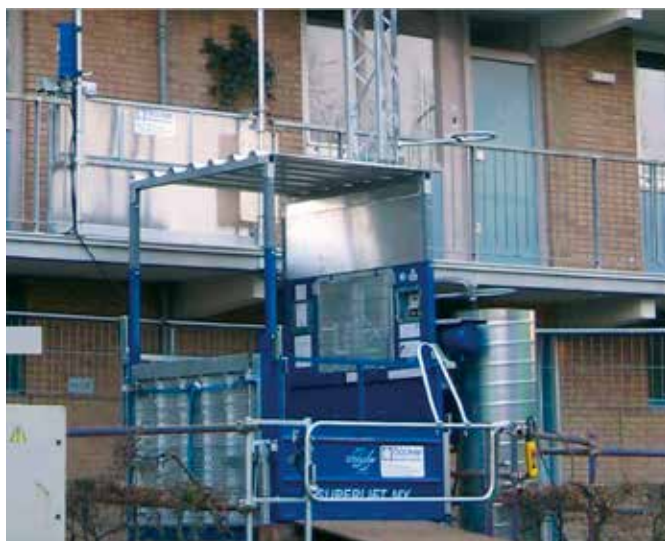
MX 1524 - A34 i heissjakt
